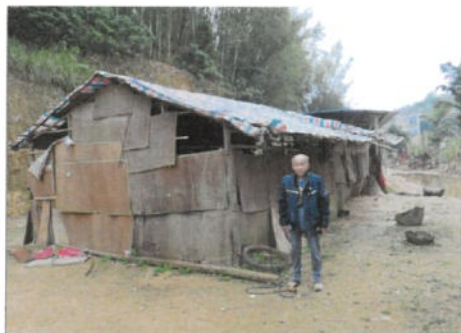
农村危房改造前
