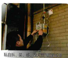
私自拆、装、移、改天然气管道设备
